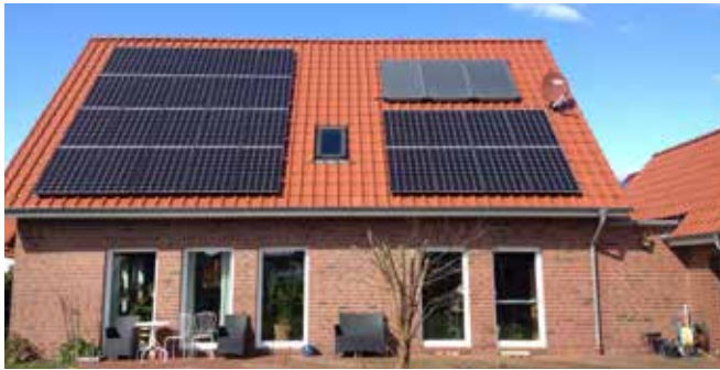
Installierte Photovoltaik-Anlage auf einem Einfamilienhaus.
